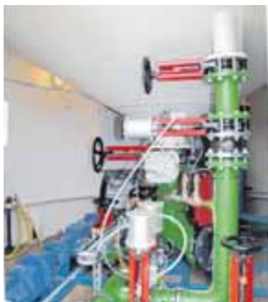
Im unteren Teil des Turms befindet sich der Motor der Anlage.
