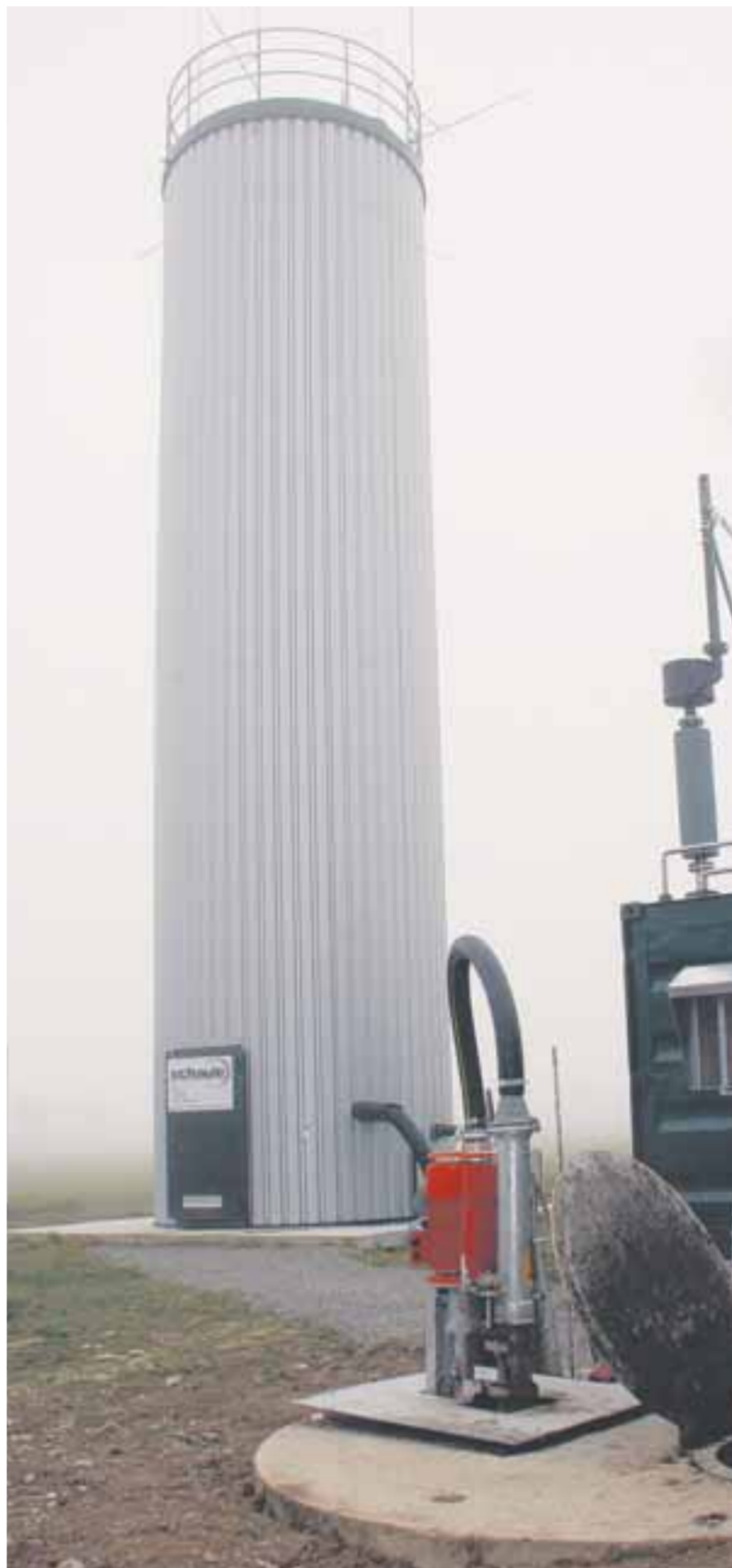
Gülle und Substrat kommen in den Anmischbehälter der Kompaktbiogasanlage. Im Container im Hintergrund befindet sich die Schaltzentrale. Im Turm findet die Gärung statt.
