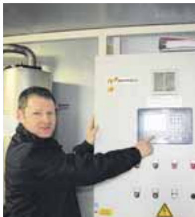
Unternehmer Lothar Schaule zeigt die Schaltzentrale der Biogasanlage.
